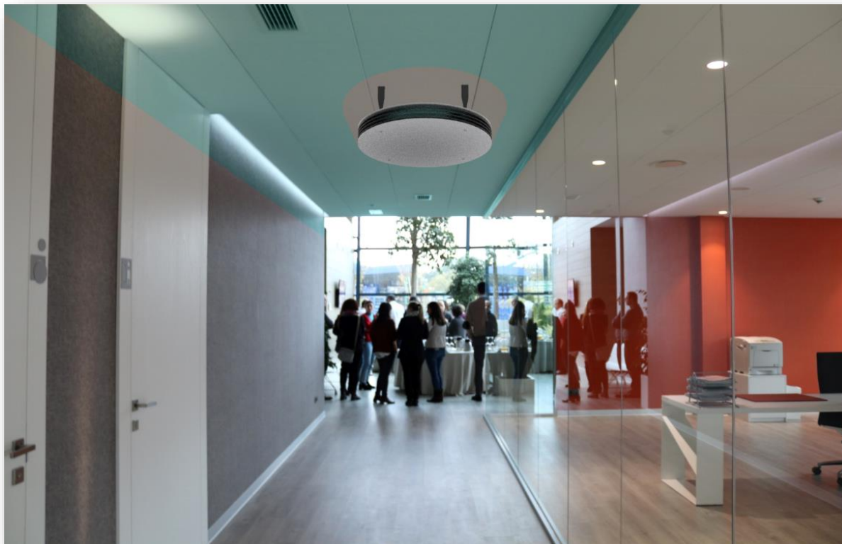
Ejemplo de equipo de desinfección de aire situado en un pasillo
