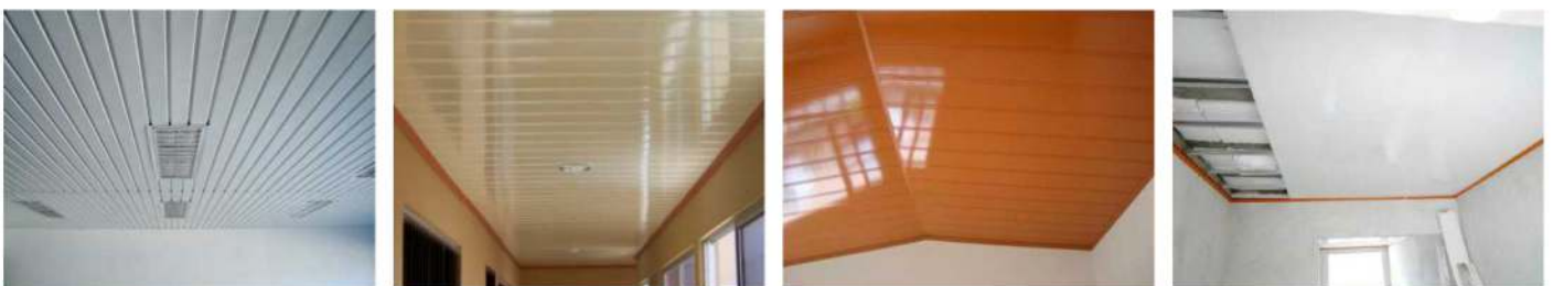
Instalación de falso techo de P.V.C. blanco con perfil de unión Ref. 155
